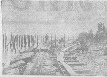
Сазрушенныя производящіяся нынѣ укрѣпленія берега Ланжерона.
